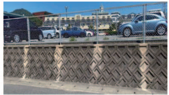
写真-3 フェンス下の汚れムラの例
